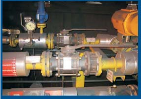
Шаровые краны КНА-FL на трубопроводах с азотом
