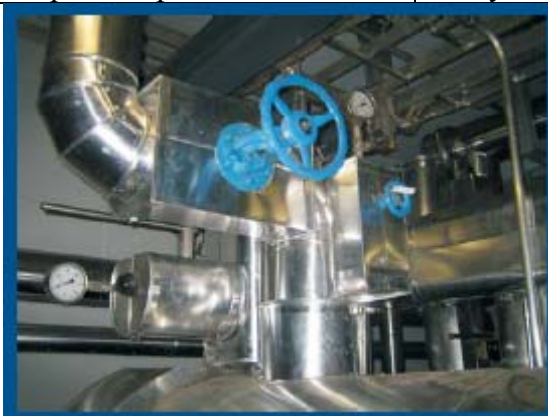
Вентили KVN в изоляции
